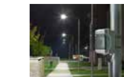
Beleuchtungssteuerung einer Wohnanlage mit Parkplatz
