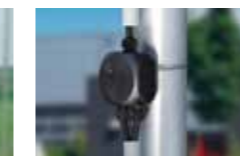
Energieversorgung einer Überwachungskamera im öffentlichen Raum
